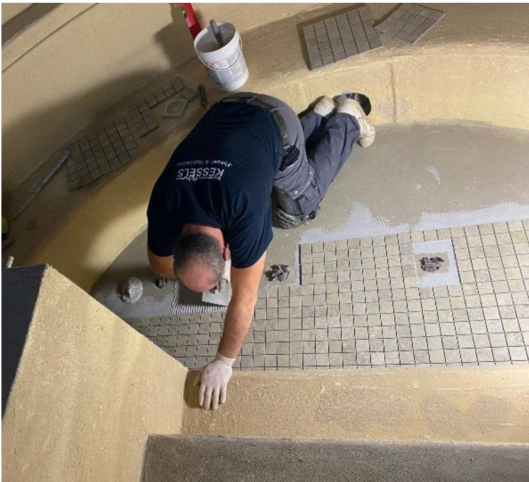
Im Römischen Bad verlegten und verfugten die Fliesenleger die keramischen Beläge gefügedicht und chemikalienbeständig mit dem Epoxidharzmörtel PCI Durapox Premium. ( Link zum hochauflösenden Photo, ©PCI Augsburg GmbH)
