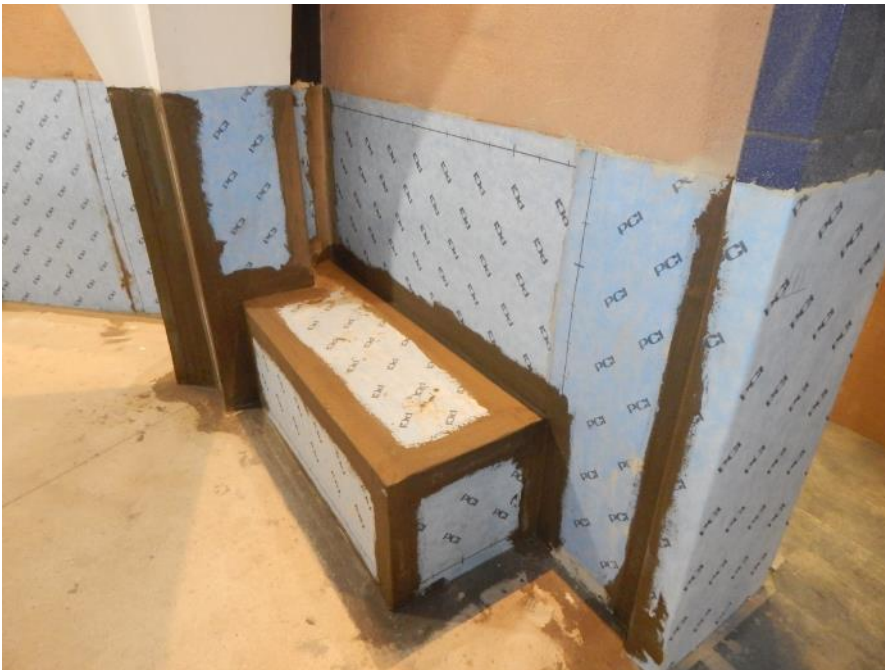
Die Rohform der beheizten Ruhebänke besteht aus PCI PowerBoard Hartschaumplatten, abgedichtet mit PCI Pecilastic W. ( Link zum hochauflösenden Photo, ©PCI Augsburg GmbH)
